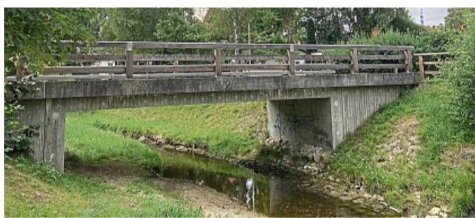
Durch Abstürze an mehreren Stellen in der Goldach wird die Durchgängigkeit der Fische behindert. JOHANNA FURCH
